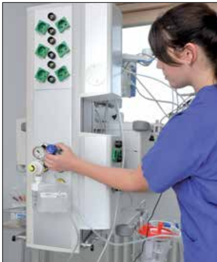
Versorgungssäule mit O 2 und Vakuumregler
